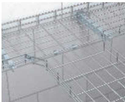
Réalisation d'un té de dérivation de chemins de câbles en treillis Après la découpe des longerons latéraux et le pliage des éclisses, il est possible de réaliser des dérivationes en T à monter soi-même à l'aide de l'éclisse d'angle GEV 36 et de l'éclisse couvre-joint GSV 34.
