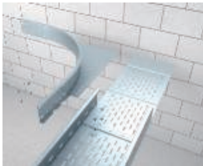
Réalisation d'un té de dérivation avec pièce d'angle à monter Montage de la première pièce d'angle à monter WEAS 110.
