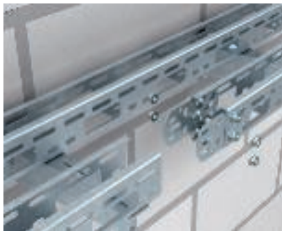
Éclissage de canal support de luminaires Eclissage linéaire horizontal de canal AZ type LTS, à l'aide d'éclisses droites et coudées type VF AZK.
