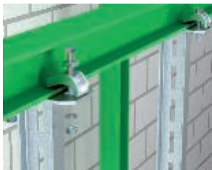
Serrage direct sur poutre acier Serrage direct sur poutre acier d'un pendard en I à l'aide d'un crapaud de serrage lourd de type TKS-S-30. Cheminement parallèle à la poutre métallique.
