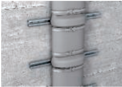
Fixation de l'enrubannage par colliers de serrage métalliques dans une installation sur rails
