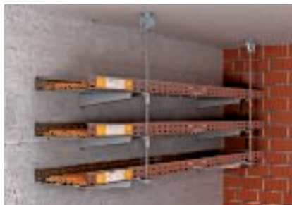
Montage mural, vertical et multi-niveaux avec dispositif de sécurisation des tiges filetées
