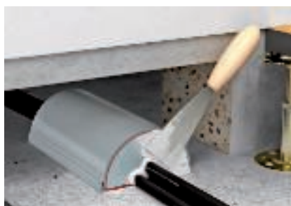
Masticage étanche aux gaz et fumées des surfaces avec l'enduit coupe-feu ASX
