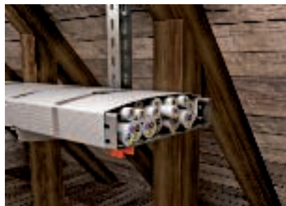
Enrubannage de chemin de câble pour installation en environnement hautement inflammable
