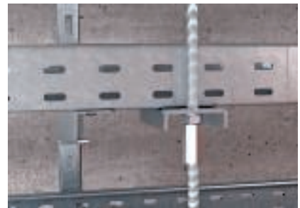
Fixation de tiges filetées sur le chemin de câbles en cas de disposition multi-niveau
