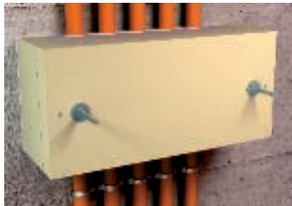
Montage de décharge de traction associée à une pose par bride individuelle
